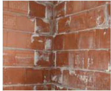
Starke Ausblühungen mit Bartbildung müssen entfernt werden (trocken abbürsten)
