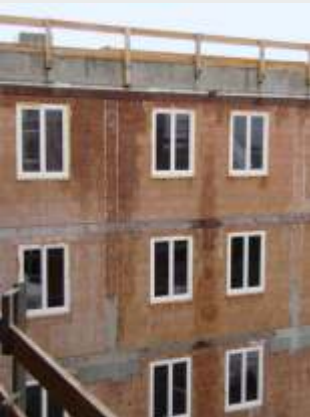
Stark durchnässstes Mauerwerk
