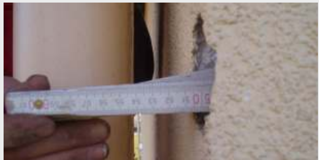
Spechtnest in VWS-Fassade im Eckbereich
