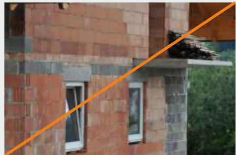
Mischmauerwerk ist kein optimaler Putzgrund.
