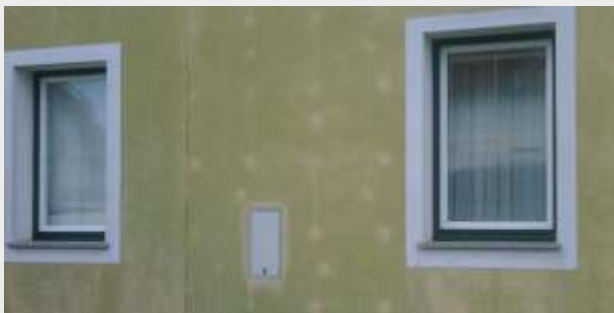
Algenbefall auf Wärmedämmplatten
